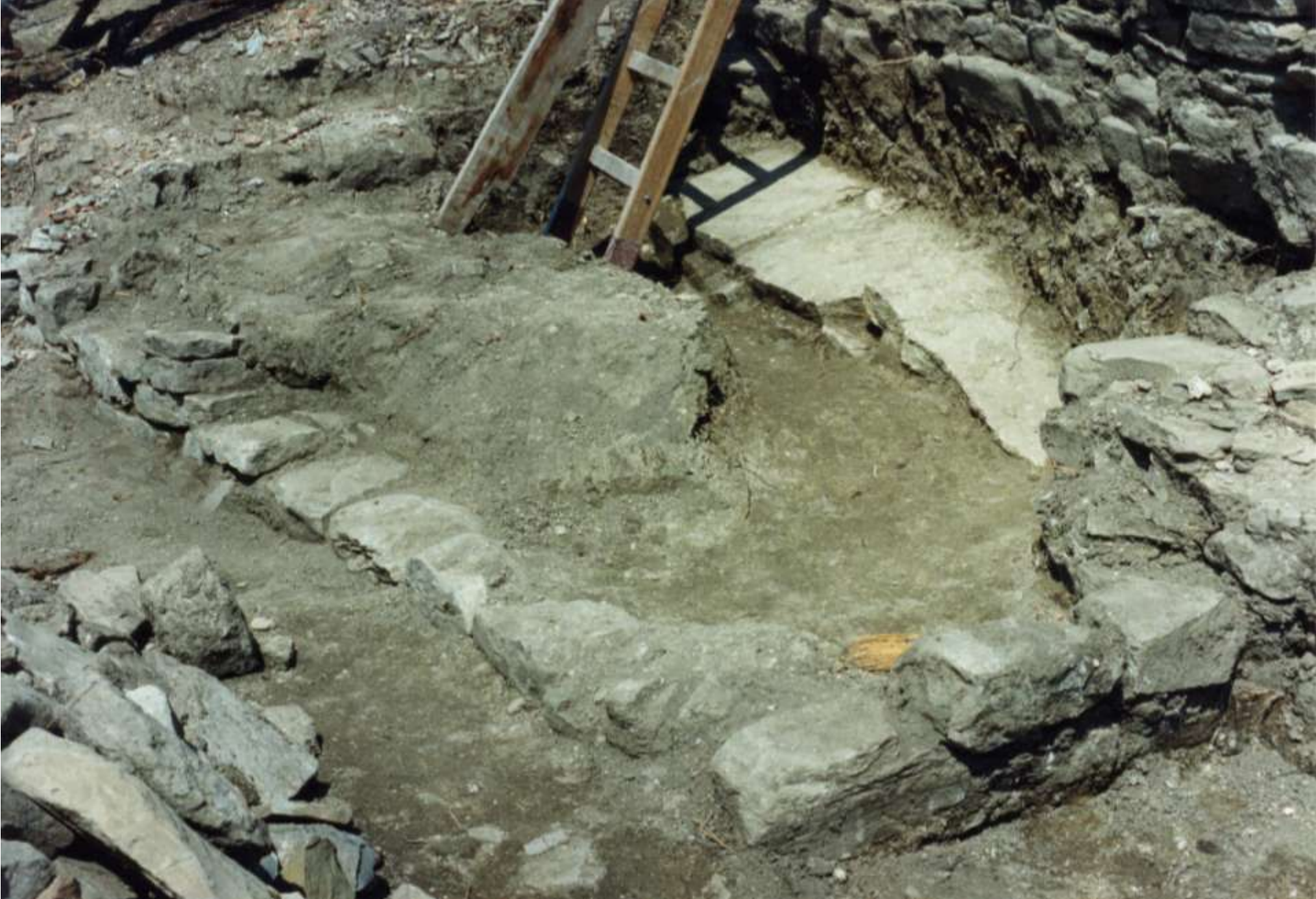
Αβαθής θεμελίωση στη θέση αυτή και αποκάλυψη τάφου που επεκτεινόταν και κάτω από την πάσχουσα τοιχοποιία
