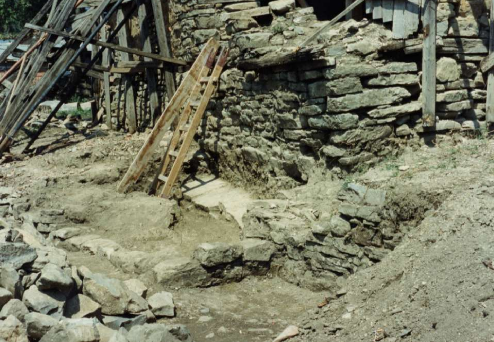
Αβαθής θεμελίωση στη θέση αυτή και αποκάλυψη τάφου που επεκτεινόταν και κάτω από την πάσχουσα τοιχοποιία
