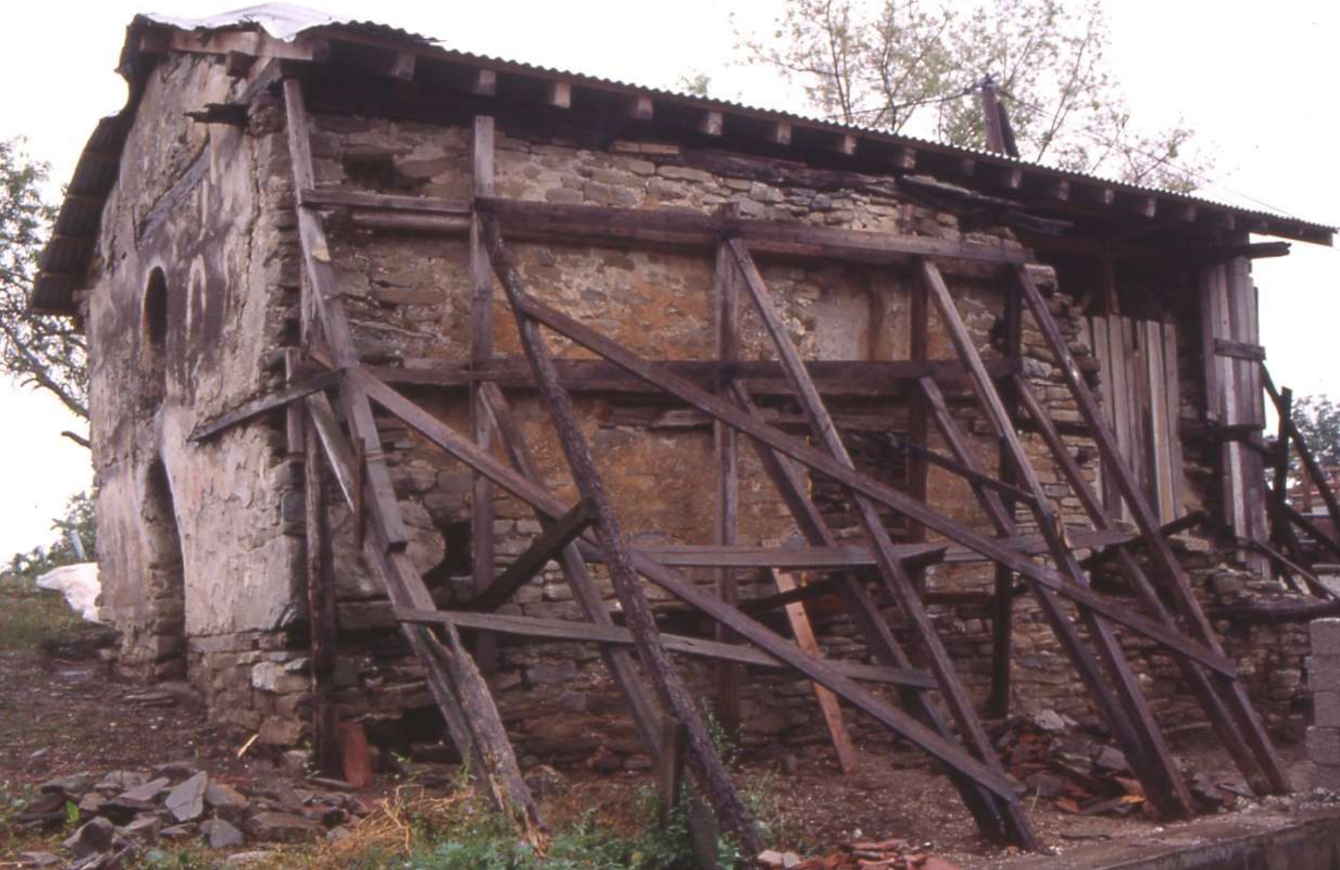
Έντονη απόκλιση από κατακόρυφο νότιου τοίχου και καταστροφή ΝΑ γωνίας Κατεστραμμένη στέγη
