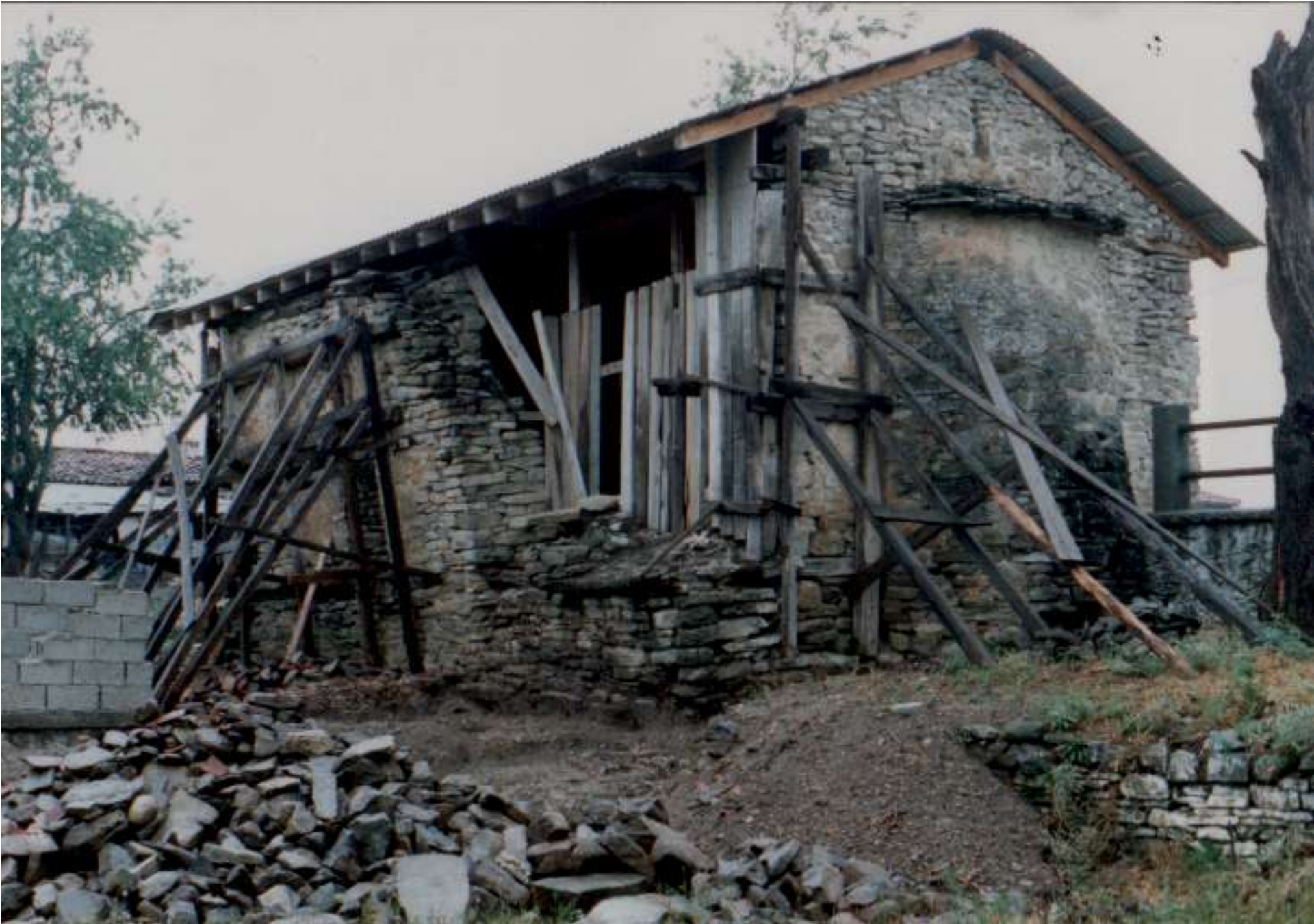
Έντονη απόκλιση από κατακόρυφο νότιου τοίχου και καταστροφή ΝΑ γωνίας
