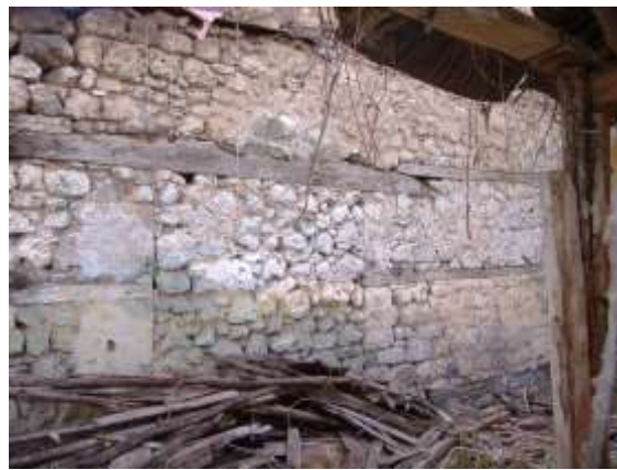
Εικ. 20 ΝΑ κτήριο. Η φραγμένη πόρτα στο ισόγειο
