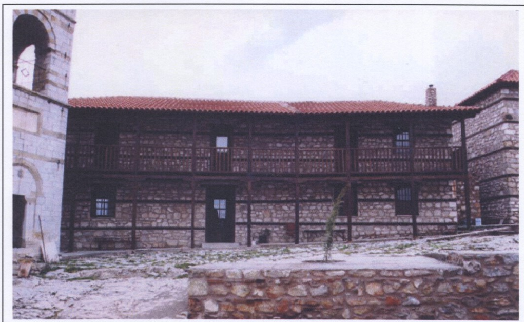
Μονή Ζάβορδας στο νομό Γρεβενών. Προσκτίσματα της μονής. Επάνω: η κατάστασή τους μετά τους σεισμούς Κάτω: μετά την ανακατασκευή τους
