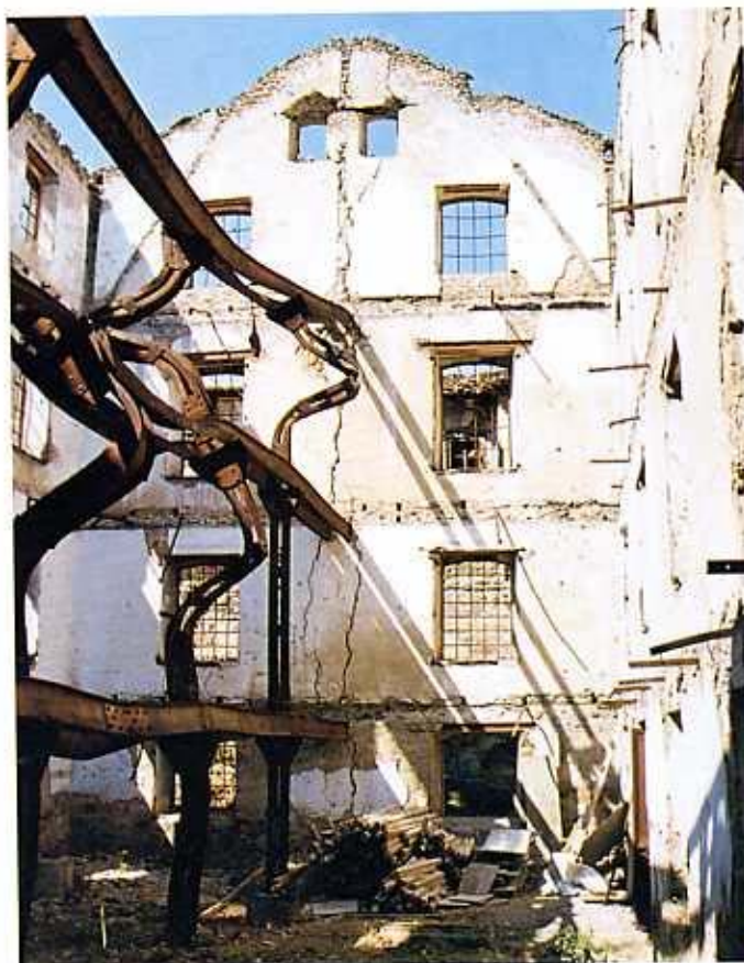
Εσωτερικό του υδρόμυλου μετά την καταστροφική πυρκαγιά του 1981. Διακρίνονται χαρακτηριστικά τα παραμορφωμένα από την πυρκαγιά σιδερένια εσωτερικά φέροντα στοιχεία.
