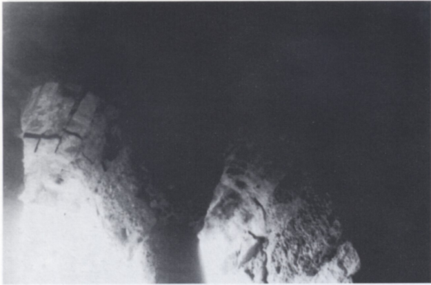
Εικ. 26. Άγ. Γεώργιος Ομορφοκκλησιάς. Ρωγμές στα εσωρράγια των τόξων.
