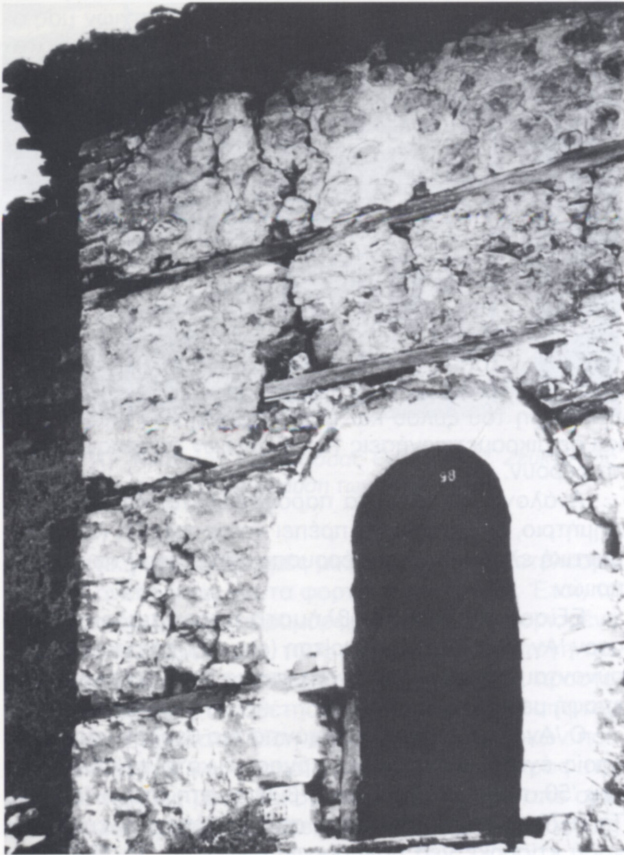
Εικ. 13. Άγ. Νικόλαος του Τζώτζα. Ρωγμές στη νότια τοιχοποιία του νάρθηκα.
