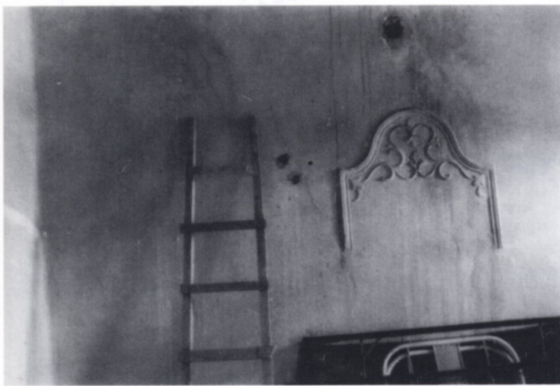
35. Αρχοντικό Σκούταρη. Νέα ρωγμή δίπλα σε παλαιά επισκευασμένη και στριφώνια για την παρακολούθηση της εξέλιξής της.
