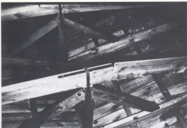
Εικ. 19. Άγ. Νικόλαος Αρχόντισσας Θεολογίας. Ζευκτά της στέγης. Μετατοπίσεις και θραύση των ελκυστήρων.
