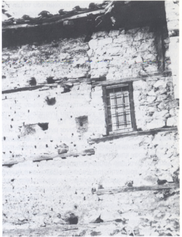
Εικ. 14. Άγ. Νικόλαος του Τζώτζα. Καταστροφές ωμών πλίνθων της τοιχοποιίας.
