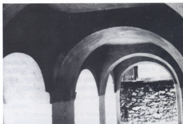
Εικ. 24. 'Αγ. Τρείς. Νότια στοά. Ρωγμές στα εσωρράχια των τόξων και στον τοίχο αντιστήριξης του δρόμου.
